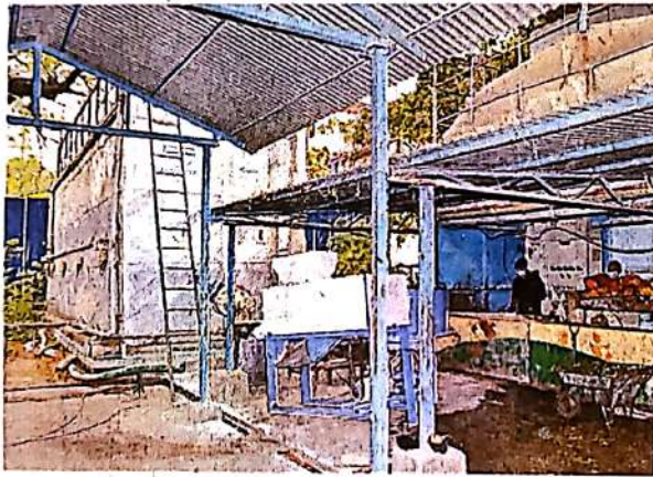
कज्जाकपुरा में नगर निगम का वेस्ट टू एनर्जी प्लांट • जागरण
