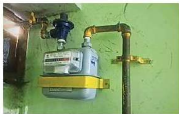
सीतापुर में सिविल लाइंस मुहल्ले के एक घर में लगा गैस मीटर • जागरण
